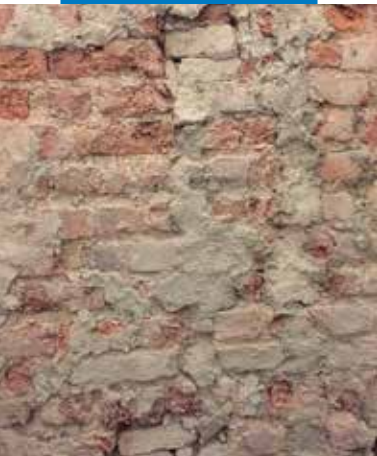
Egyenletlen, felújításra szoruló felület
